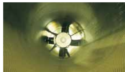
Система вытяжки воздуха 110 кВт
